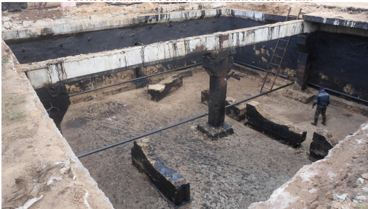
Рис. 19 Внутреннее устройство мазутохранилища №1. Обобщенная характеристика трубопроводов систем теплоснабжения: а) Котельная «Квартальная»
