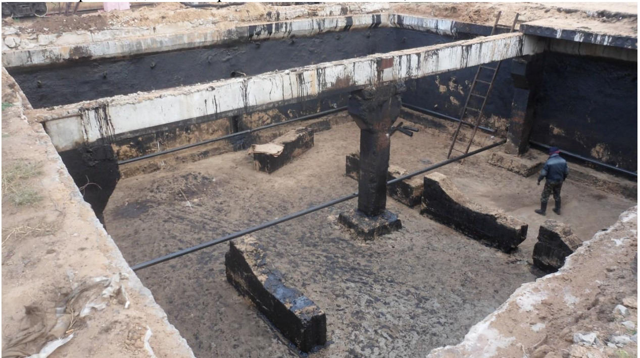
Рис. 19 Внутреннее устройство мазутохранилища №1
